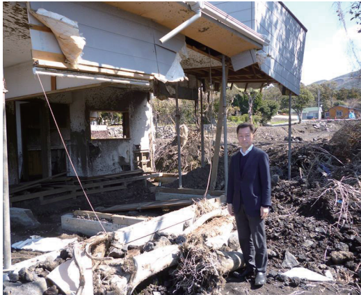
平成26年3月 大島台風被害調査(東京都大島町)
