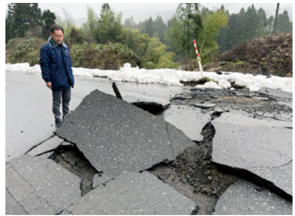
輪島市で被災状況調査(1月3日)
